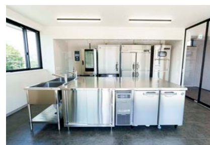
事務所 3F セントラルキッチン
