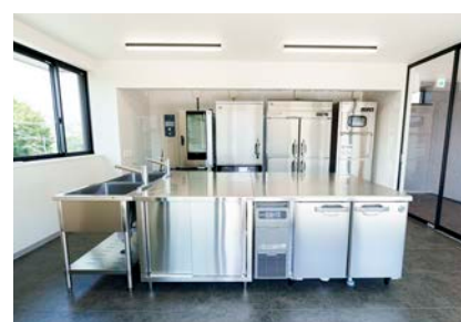
事務所 3F セントラルキッチン
